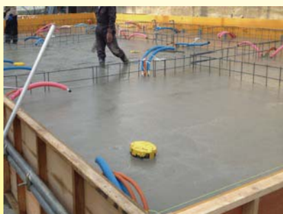
基礎コンクリート打設後の様子。コンクリートから出ている青とピンクの配管が杭の中に導入了地中熱採熱用の配管を示しています。
